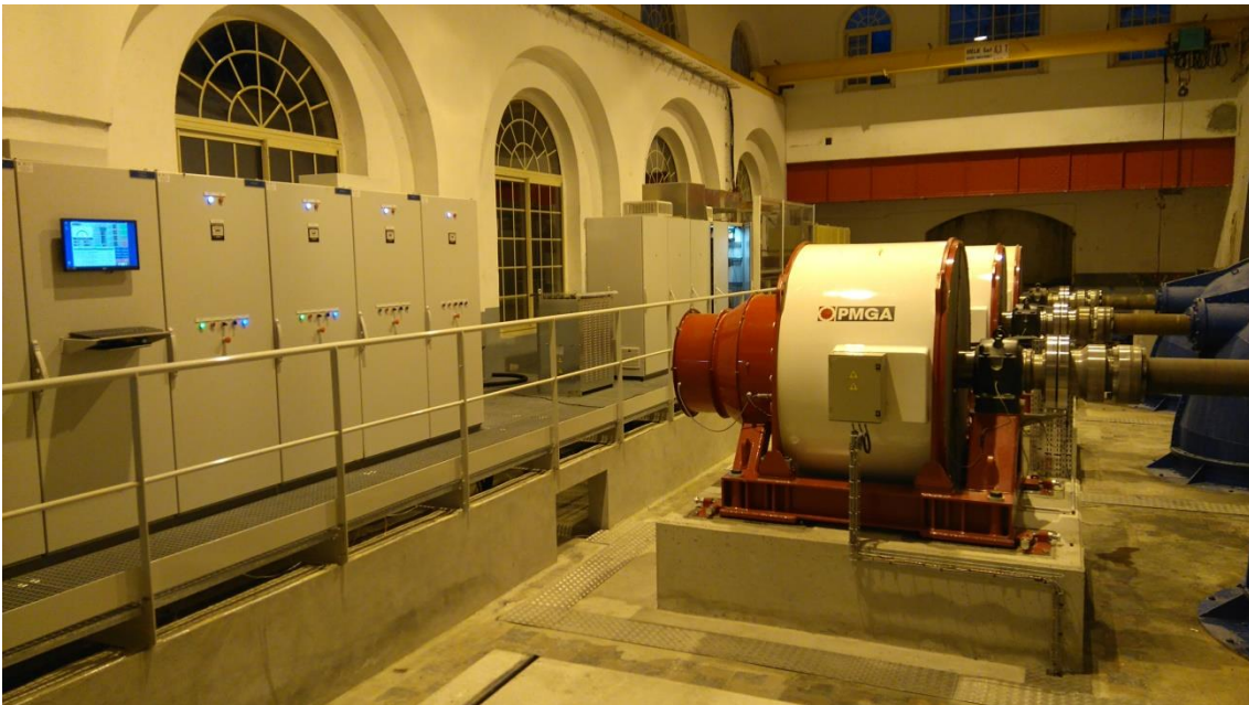
Innenansicht des Kraftwerks
