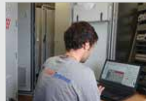
Puštanje postrojenja u pogon
