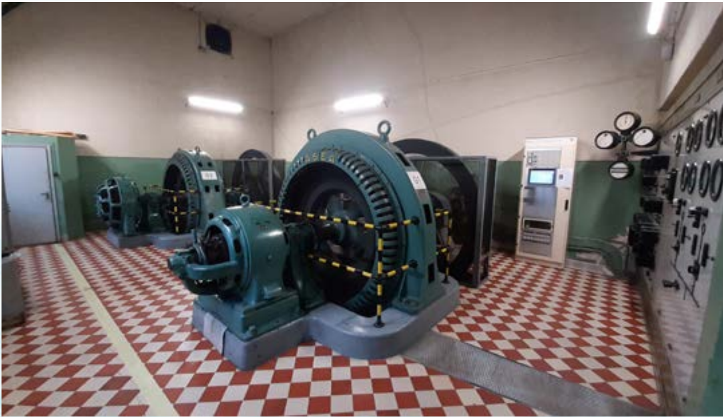
Historiskt generatorrum oförändrat före och efter modernisering
